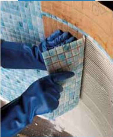
Укладка стеклянной мозаики 2x2 в бассейне с использованием Adesilex P10 и добавки Isolastic, разбавленной водой в соотношении 1:1
